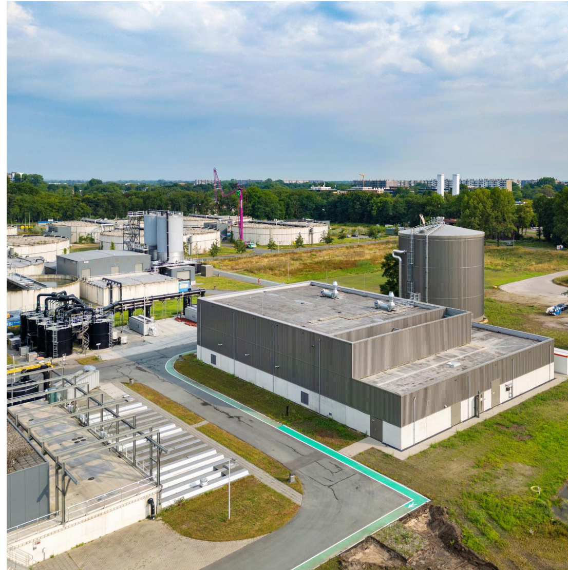
Warmtepompinstallatie op het terrein van de rioolwaterzuivering Utrecht.
