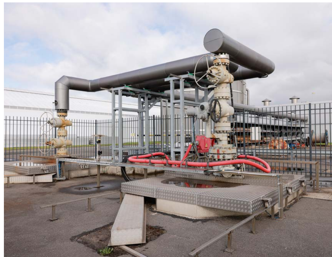
Aardwarmte-installatie in Heemskerk. De gebouwde omgeving, glastuinbouw en industrie zijn mogelijke afnemers van aardwarmte
